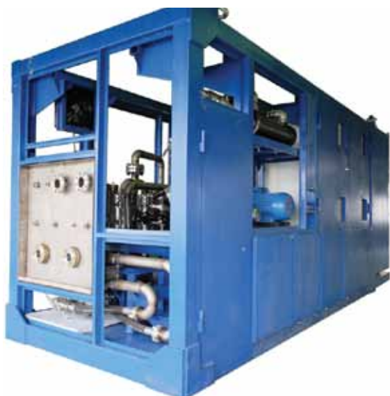
Стенд Q48 со снятой зашивкой
