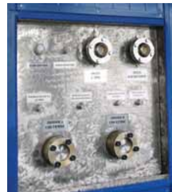
Панель распределительного щита
