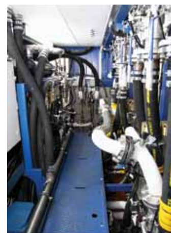
Внутри модуля «Насосная»
